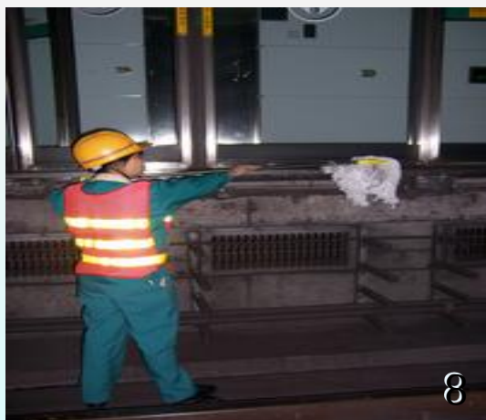
8.用地拖拖干净屏蔽门下方铁板的污水
